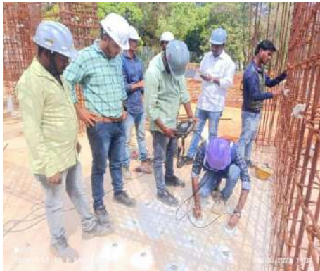
आईआईएससी मुख्य परिसर, बैंगलोर में अतिरिक्त बुनियादी ढांचे के निर्माण का एनडीटी कार्य
